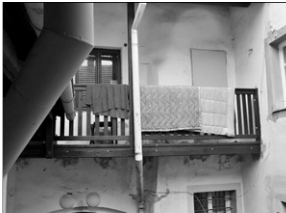
Opravy vstupních prostor a dvorní fasády čekají dům čp. 63 v Křišťanově ulici. Foto Ing. arch. Dana Marková
